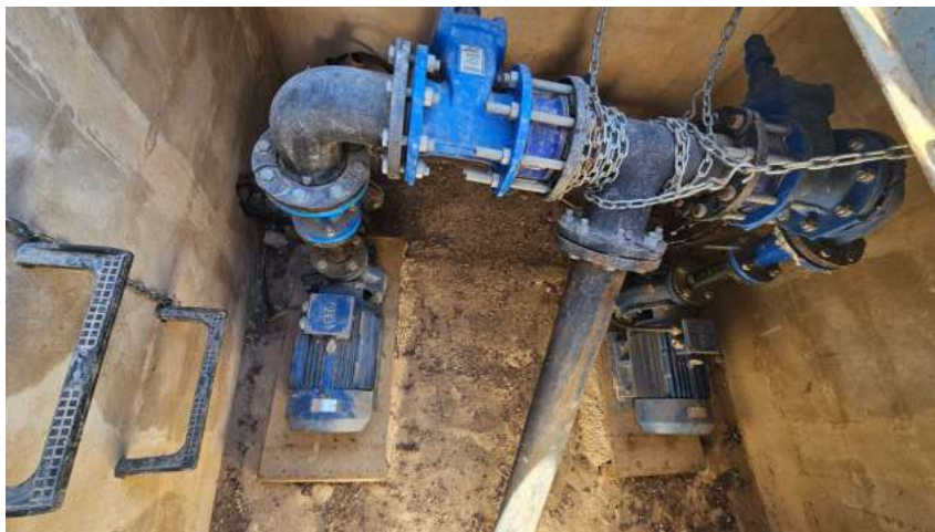
Figura 19. Bombeo punto compra AMAEM.
