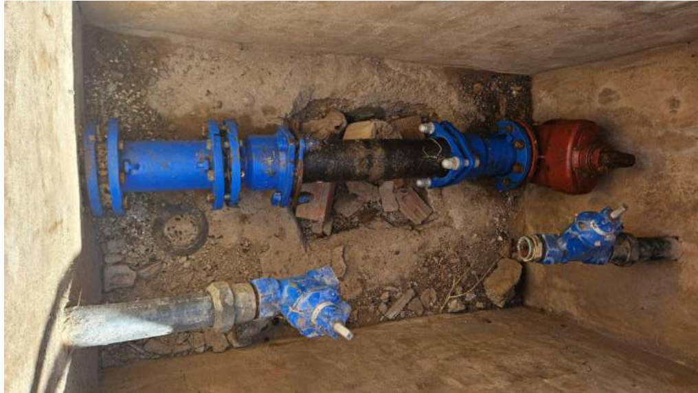
Figura 21. Arqueta válvula de regulación.
